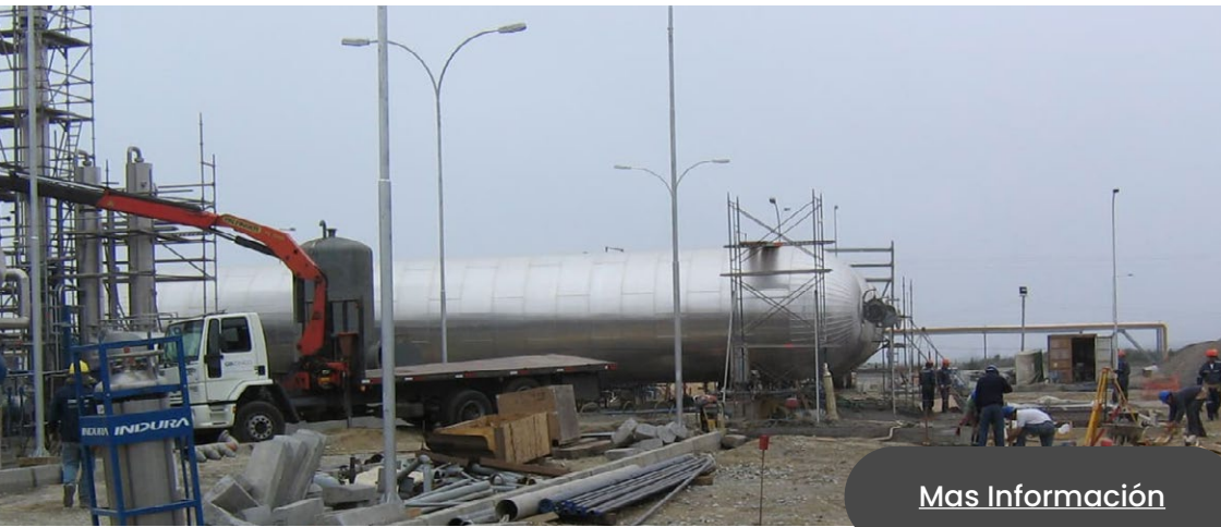
Planta de recuperación de Dióxido de Carbono
