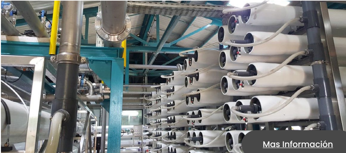
Planta de osmosis inversa Central Nehuenco Colbún
